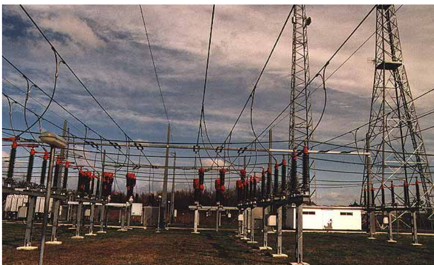
Σχήμα 6.15. Κέντρο υπερυψηλής τάσης
